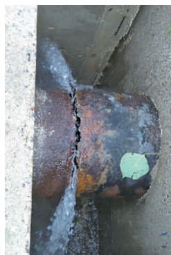
▲水道管の劣化による漏水
