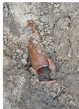
▲下水道管の劣化による破損
