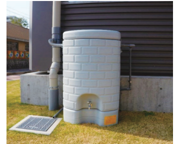
▲市役所立体駐車場に設置されている雨水貯留施設
