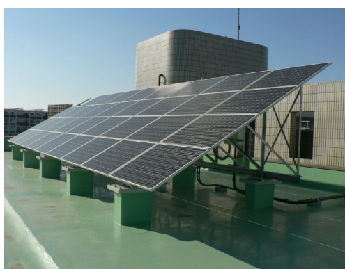
図2.19 心身障害者福祉会館に設置された太陽光発電パネル
