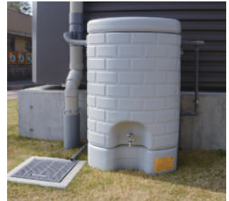
▲市役所立体駐車場に設置してある雨水貯留施設
