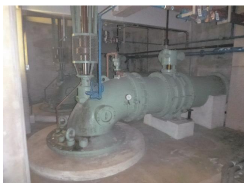
ポンプ設備 (エンジンポンプ)
