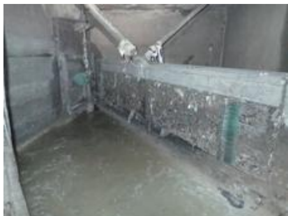
合流改善施設 (ろ過スクリーン)
