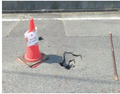
管きよの破損による道路陥没
