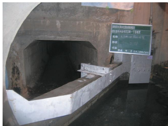
合流改善施設 (渦流式水面制御装置)
