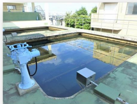
水源浄水場重力式ろ過池
