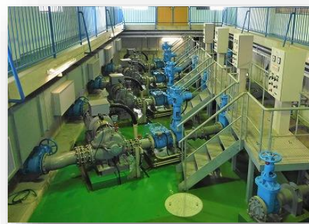
一ツ木配水場 配水ポンプ
