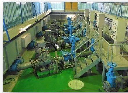
一ツ木配水場 配水ポンプ
