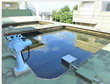
水源浄水場重力式ろ過池
