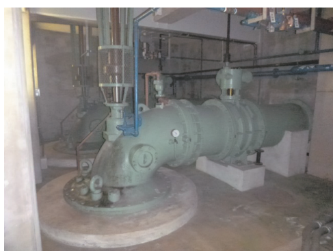
ポンプ設備 (エンジンポンプ)
