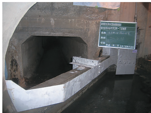
合流改善施設（渦流式水面制御装置）
