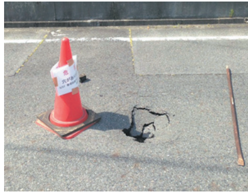
管きよの破損による道路陥没
