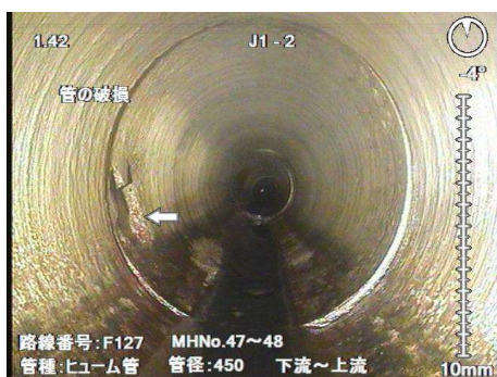
管きょの破損
