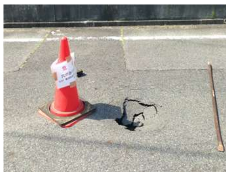
管きょの破損による道路陥没
