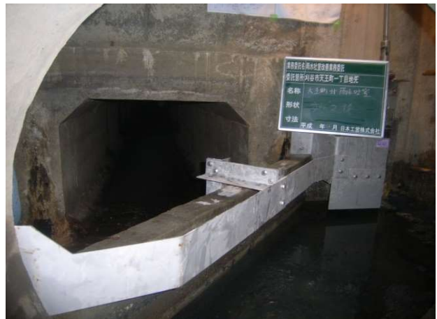
合流改善施設 (渦流式水面制御装置)
