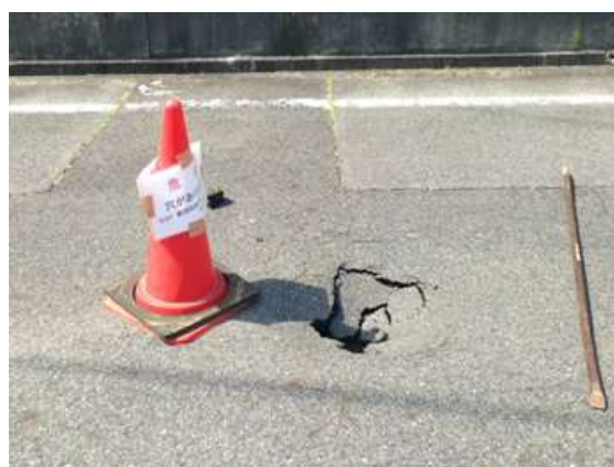
管きょの破損による道路陥没
