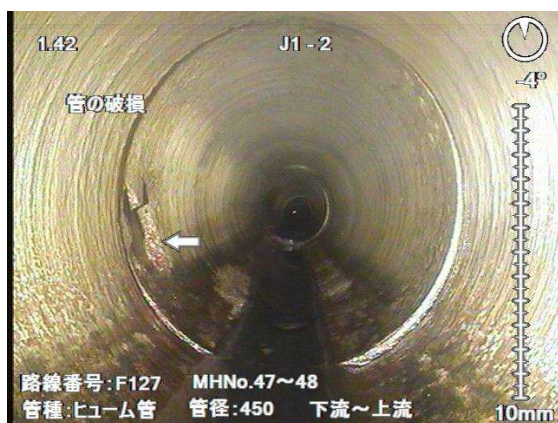
管きょの破損
