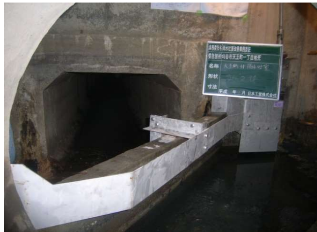
合流改善施設 (渦流式水面制御装置)
