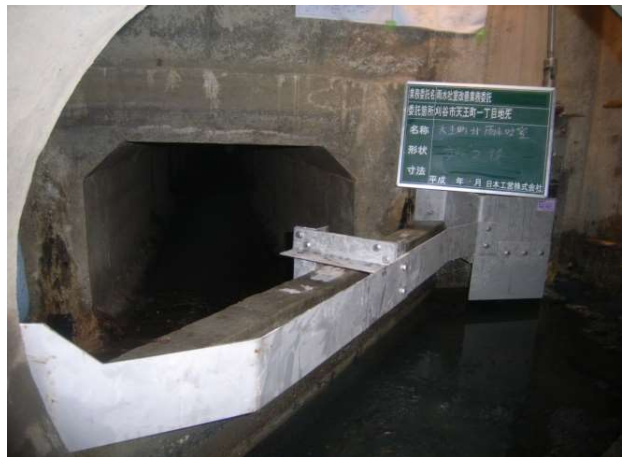
合流改善施設 (渦流式水面制御装置)
