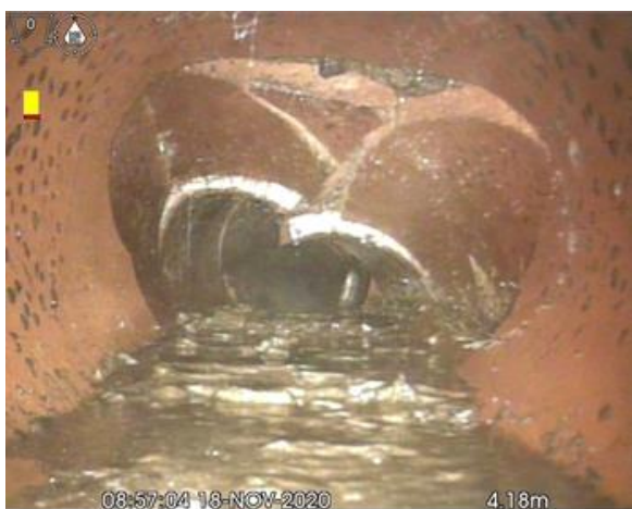
管きょの破損
