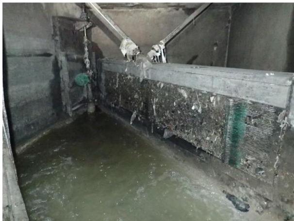
合流改善施設 (ろ過スクリーン)
