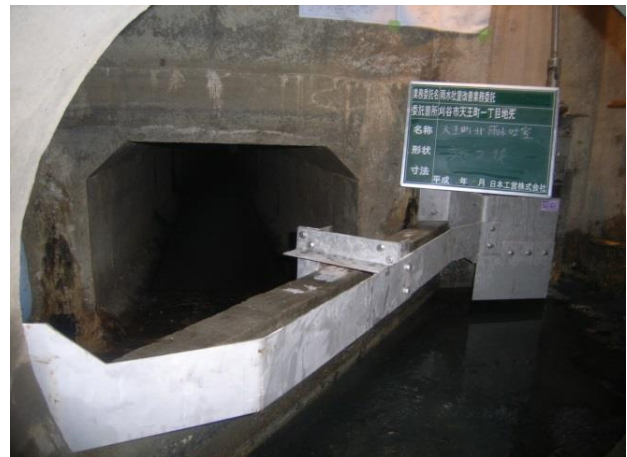
合流改善施設 (渦流式水面制御装置)
