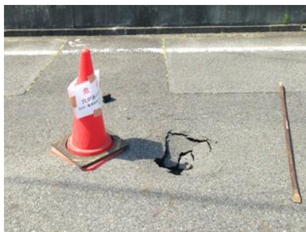
管きょの破損による道路陥没
