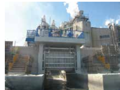
水門： 弊社の施工した水門です。 美浜町に設置しました。
