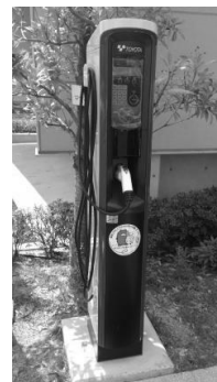
市役所に設置した普通充電器
