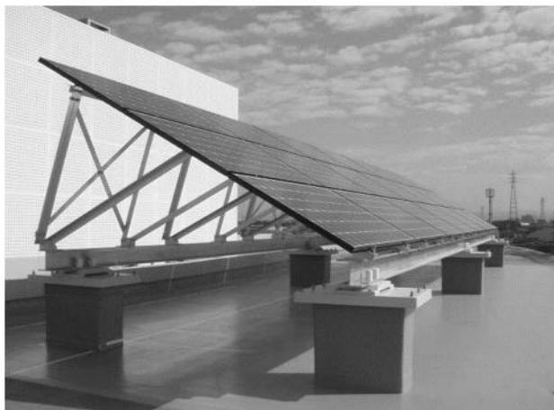
図 2.18 高齢者福祉センターに設置された太陽光発電パネル
