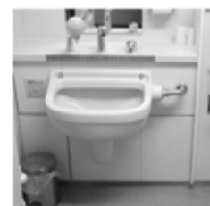
オストメイト対応設備
