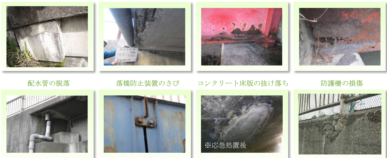
図 5 橋梁の主な損傷例
