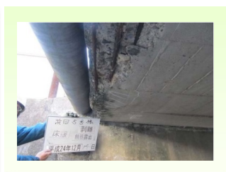
落橋防止装置のさび
