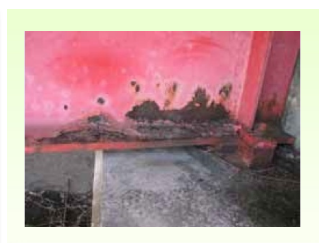
コンクリート床版の抜け落ち
