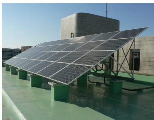
図2.19 心身障害者福社会館に設置された太陽光発電パネル
