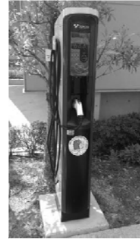
市役所に設置した 普通充電器
