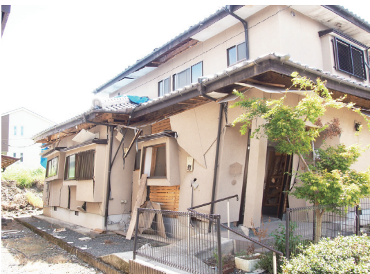
▲外壁の剥離、柱の傾き
