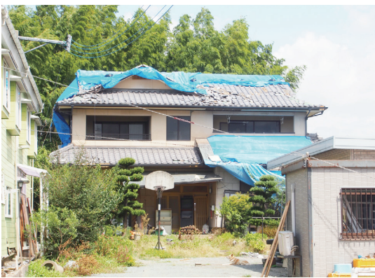
▲屋根瓦の破損、落下
