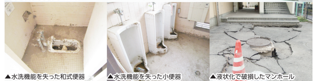
▲被災した汚水処理施設
